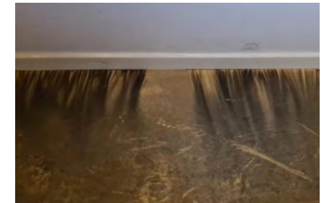
Golvlister i lägenhet på plan 3 med hisschakt på andra sidan väggen. (Foto från en boende)
