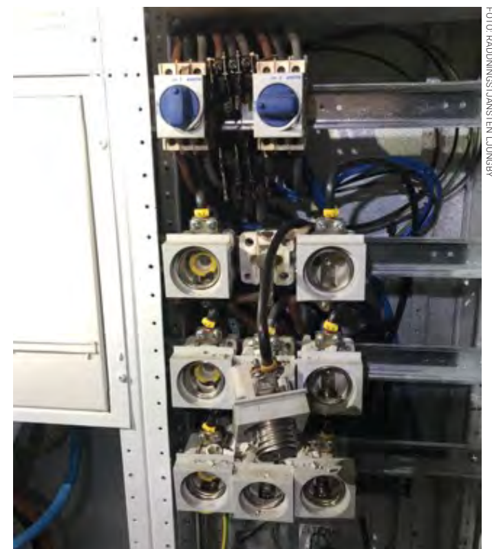
Överspänningsskador i huvudelcentralen.
