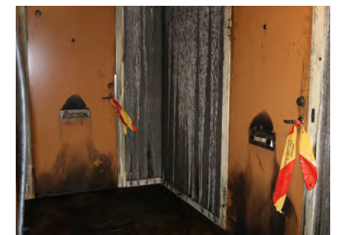
Sotskador på dörrarna i trapphuset.
