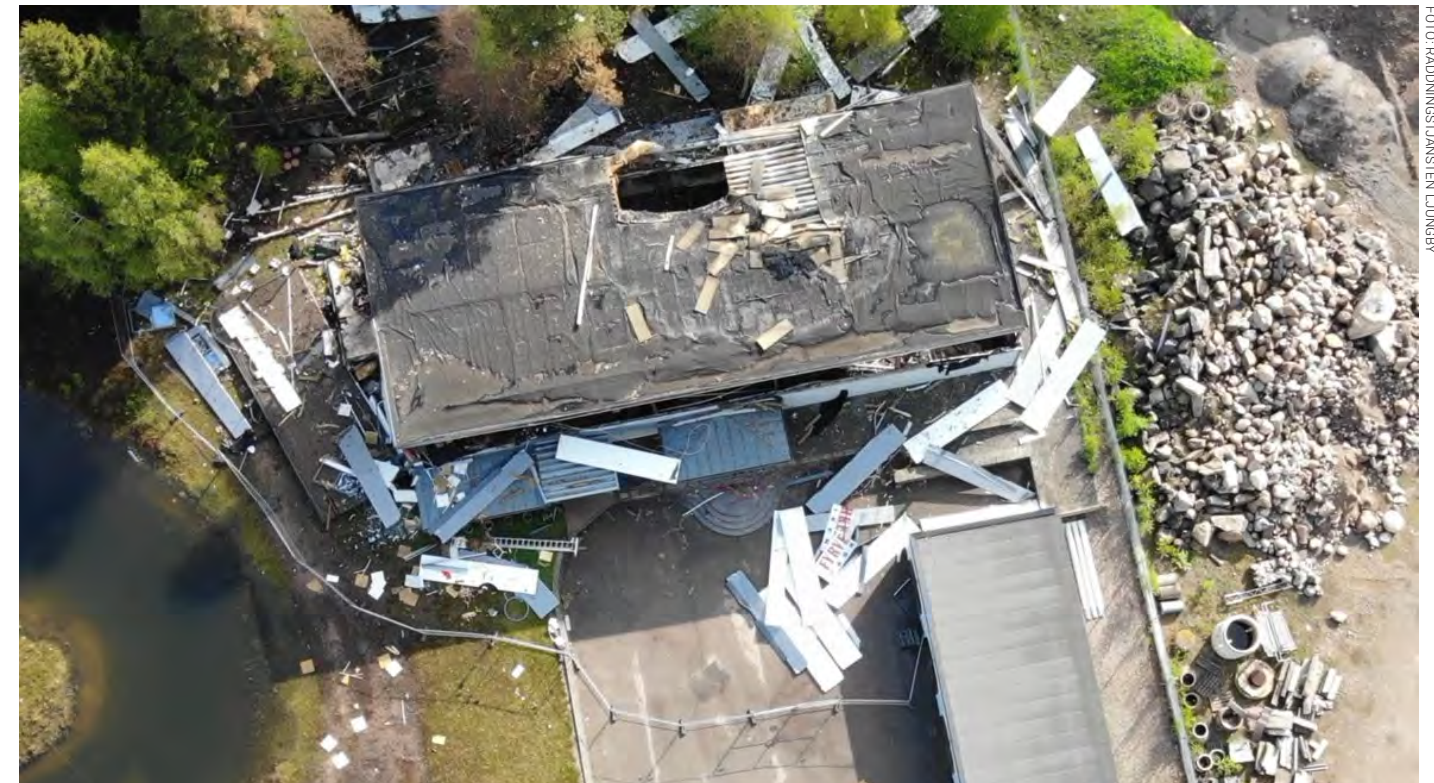
Översikt över drabbad byggnad som visar de omfattande skadorna.
