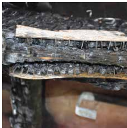
Exempel på spikbläck där infästningen försvagats av branden.
