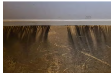
Golvlister i lägenhet på plan 3 med hisschakt på andra sidan väggen. (Foto från en boende)
