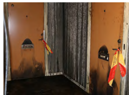
Sotskador på dörrarna i trapphuset.
